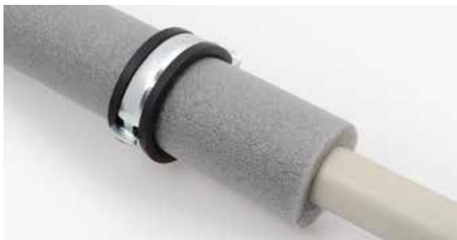
Для транспортировки горячей воды хомут крепится через изоляцию - на размер больше
